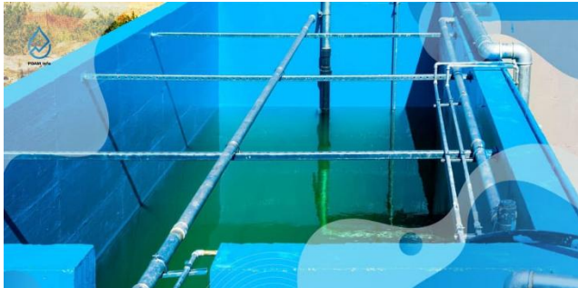
Gambar 10.21. Penampungan air hujan untuk dapat digunakan kembali
