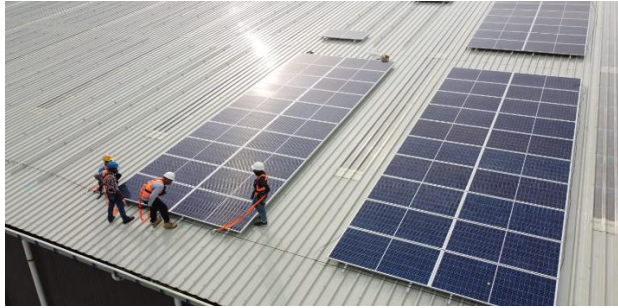
Gambar 10.20. Sistem panel surya pada bangunan
