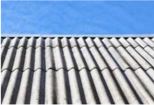
Gambar 5.2. Atap Asbes (Sumber : Kompas.com)
