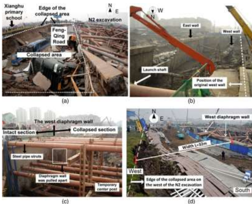
Gambar 7.6. Kondisi pasca kegagalan struktur. (Sumber : Ma et al, 2012)
