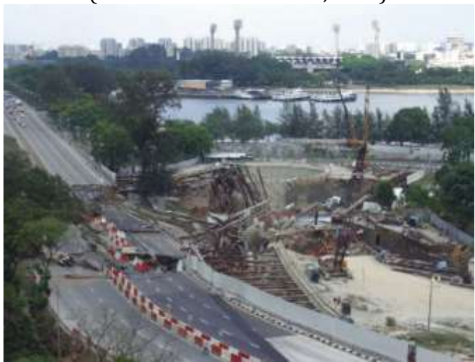
Gambar 7.3. Wilayah terdampak akibat keruntuhan di sekitar lokasi Nicoll Highway (Sumber : Whittle & Davis, 2006)
