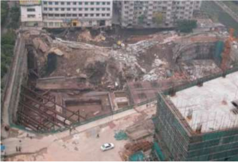
Gambar 7.7. Keruntuhan sisi selatan Foundation Pit. (Sumber : Chen et al, 2006)
