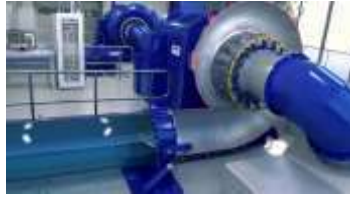
Gambar 7. 7 Pembangkit Listrik Tenaga Minihidro Sumber : (andritz hydro, 2019)
