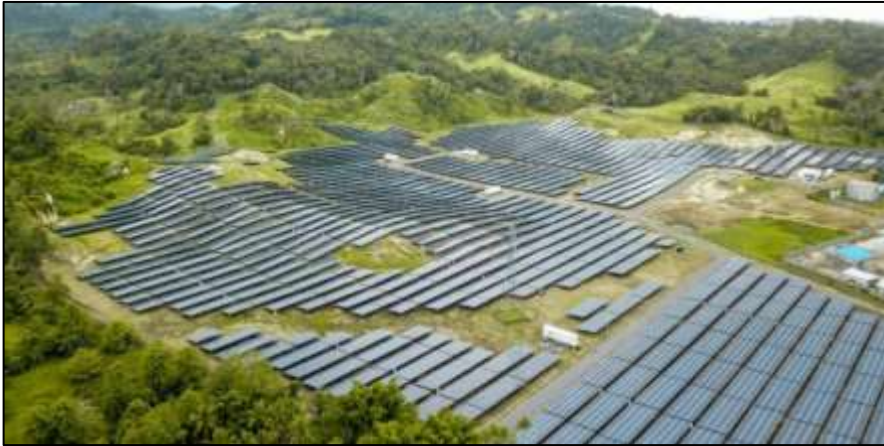
Gambar 10.2. Pembangkit Listrik Tenaga Surya di Minahasa, Terbesar di Indonesia (sumber : https://asiatoday.id )
