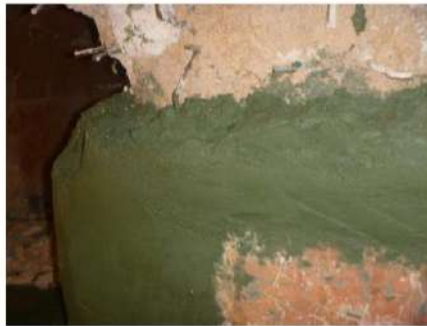
Gambar 3. 1. Pemasangan Refraktori yang tidak merata (Sumber: Basu, 2018)
