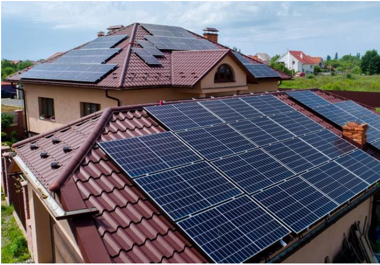
Gambar 3. 7 Peletakan Solar Panel di Atap
