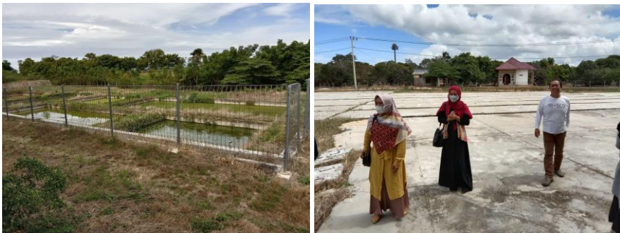
Gambar 22. Instalasi Pengolahan Air Limbah dan Lantai Penjemuran
